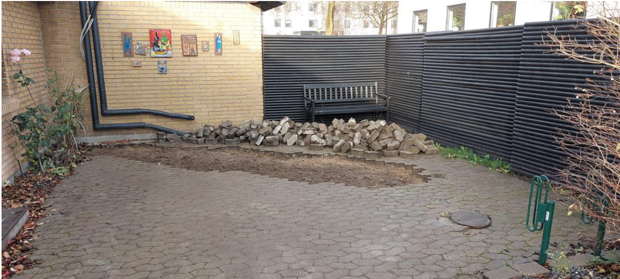
Billede 1: Den ca. 4 meter strækning imellem den nedgravede 2.500 liters fyringsolie-Tank og fyrrum. Set mod nord.
